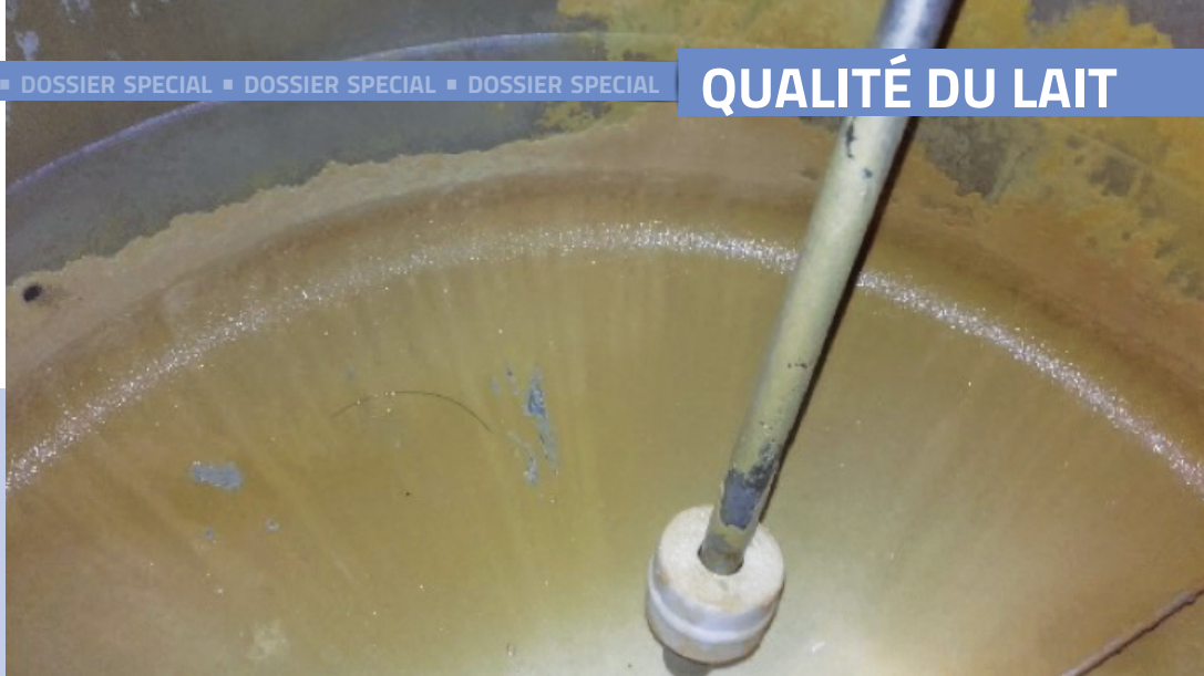
Encrassement de la chambre de réception du à une quantité d'eau insuffisante et une concentration de lessive trop faible.
